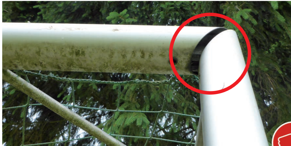
Bild 11: Hier fehlen Schrauben, so dass Pfosten und Torlatte nicht mehr fest miteinander verbunden sind.
