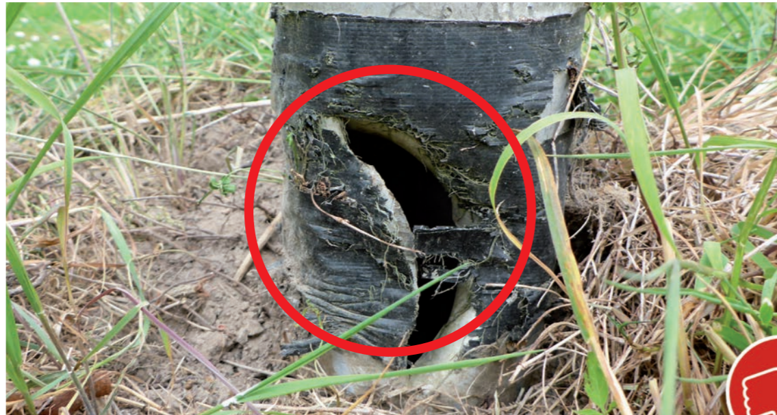
Bild 19: Deutliche Beschädigung am Pfosten
