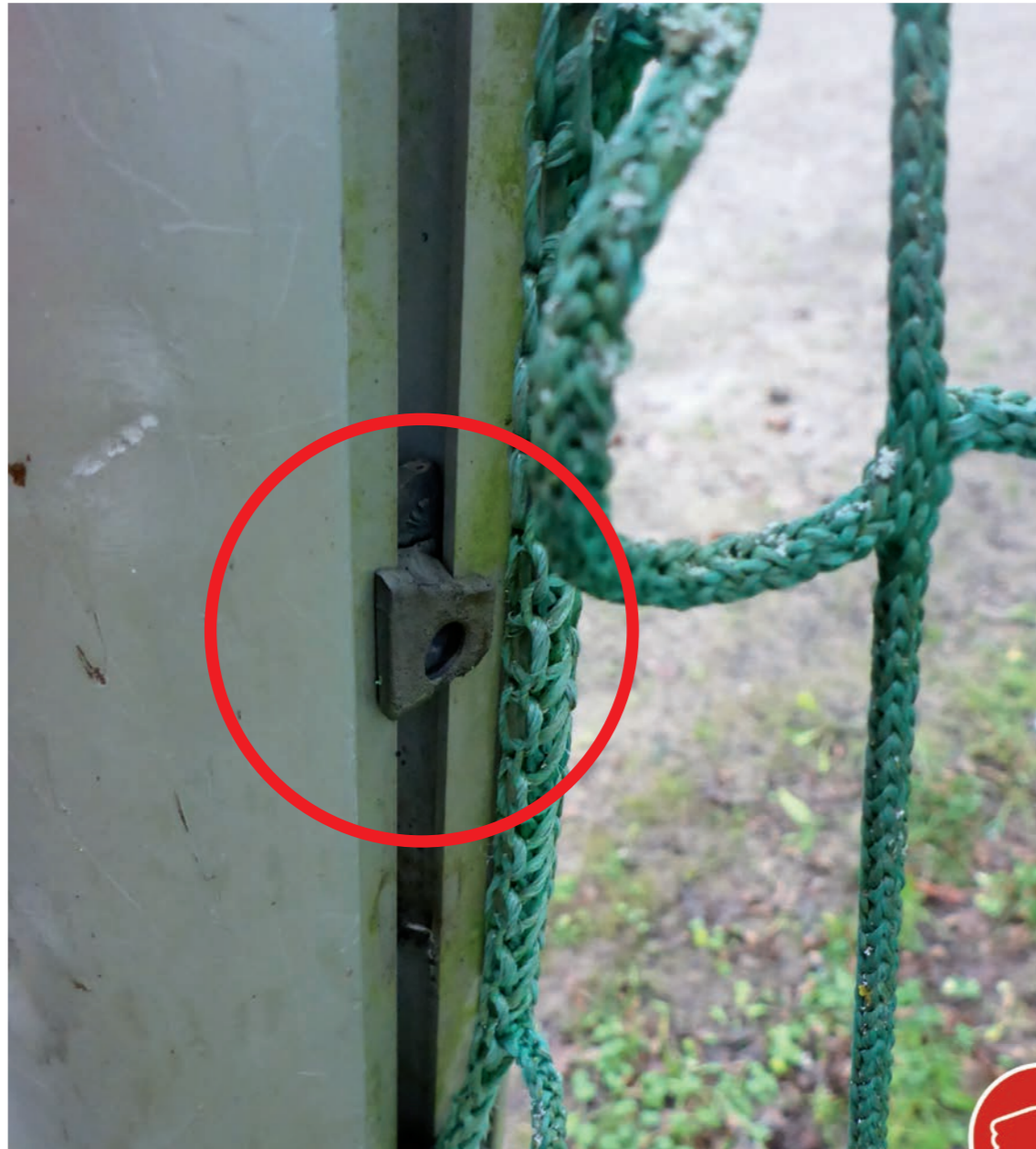
Bild 33: Gebrochene Kunststoffnetzaken sind auszutauschen.
